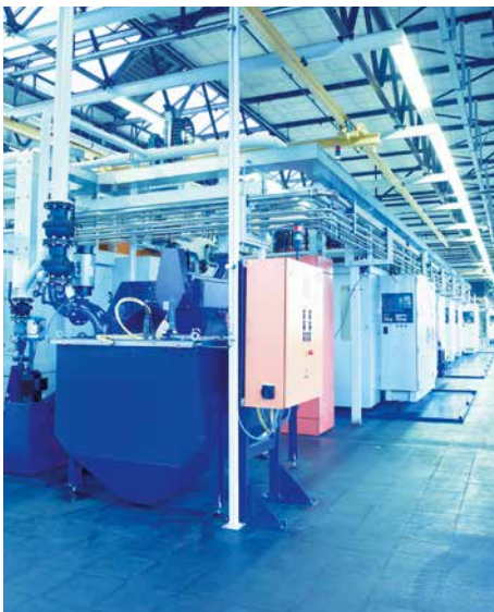
Returpumpstation för en transportlinje
