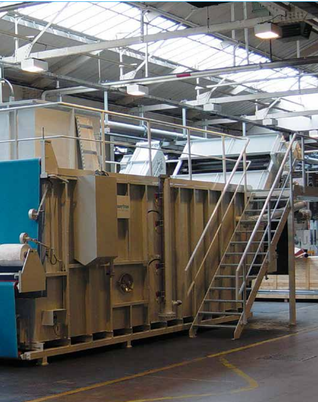
Vakuumfilteranläggning med Viavent®-returpumpsystem
