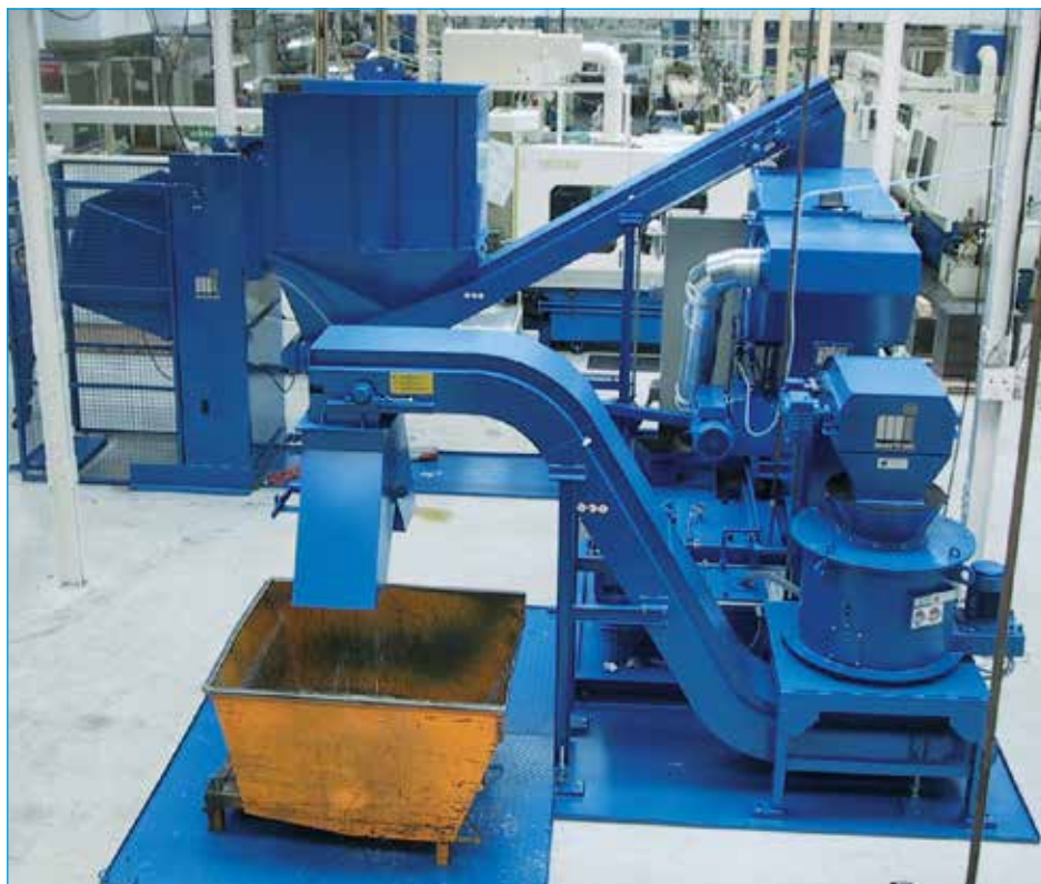
Anläggning bestående av följande komponenter: Centrifug, spånkross, spåntransportör och lastsystem för containrar.
