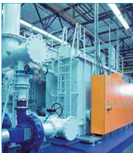
Kopplingsskåp och pumpförsörjning
