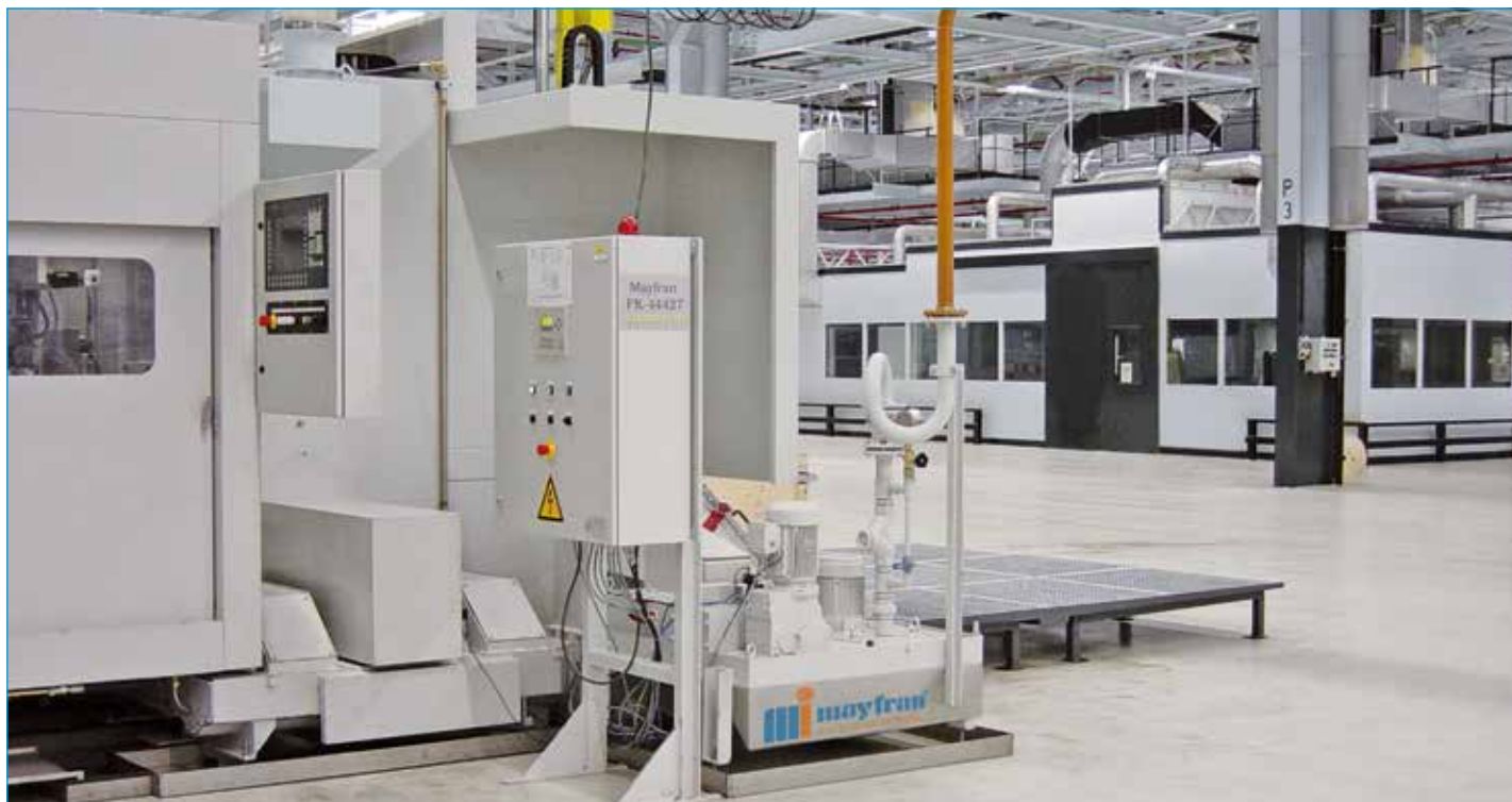
Returpumpstationer direkt vid maskinen med matning för det takmonterade systemet Viavent
